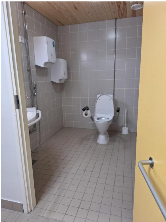
Esteetön WC pukuhuoneissa.
